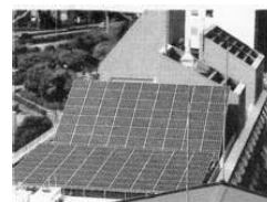
写真：屋上に設置した太陽光発電パネル
